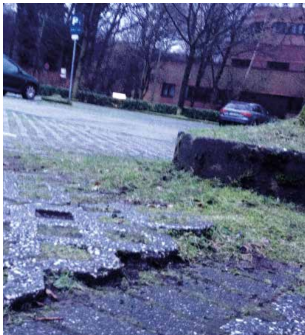
Mangelhaft: Die StuPa Opposition kritisiert den „katastrophalen“ Zustand des Duisburger Uni-Parkplatzes. (Foto: ska)
