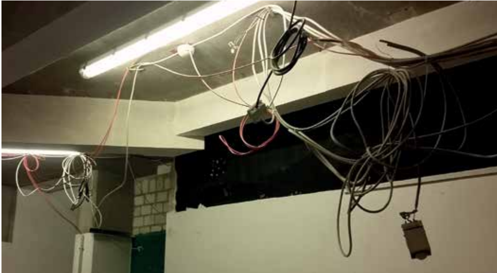
Baustellen weit und breit: Neben Wasserlachen auf dem Boden, hängt Kabelgestrüpp von der Decke. (Foto: caro)
